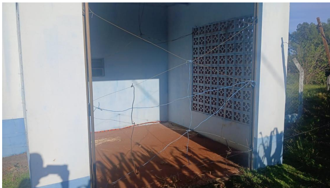
Poço localidade São Marcos
